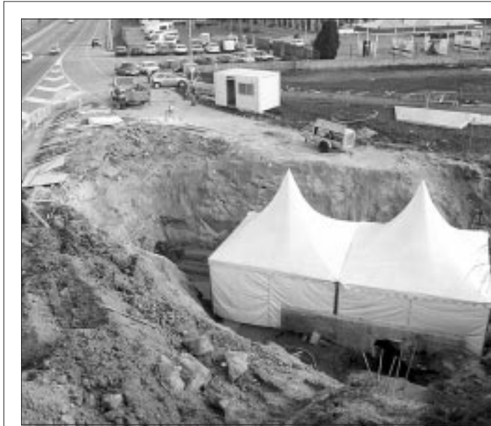
Los operarios cubrieron el socavón del Ponte da Pedra y también cerraron el vial que va a Lavedra
