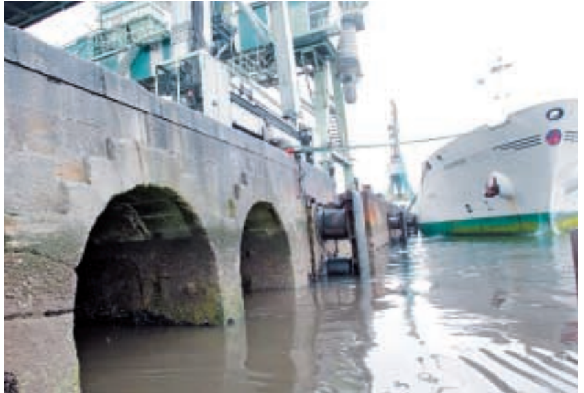
En la imagen se aprecia el vertido procedente del río de Monelos y que desemboca en la ría coruñesa | FUCO REI
